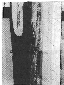
図-3 蒲生町の被害部でみられた最も激しい腐朽例
