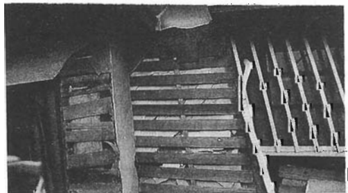
写真-6 筋違のない木ずり壁の被害(西宮市)
