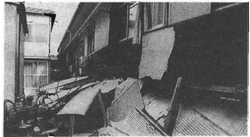
写真-4 2階建文化アパートの被害 桁方向に耐力壁がない(西宮市)
