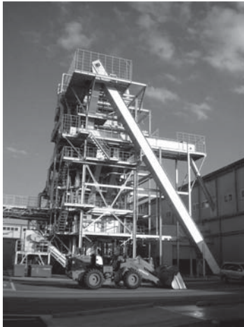
図-6 木質バイオマス発電所(荒尾市(熊本県))
