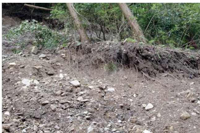
写真-7. 崩壊地における根の侵入状況
