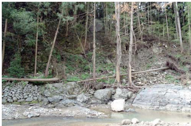
写真-8. 岩盤に根が侵入した立木
